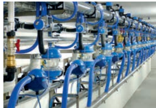
Impiantistica nel tunnel Subway installation
